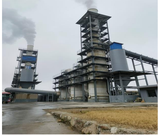
现有脱硫设施及排气筒 DA001 和 DA003
