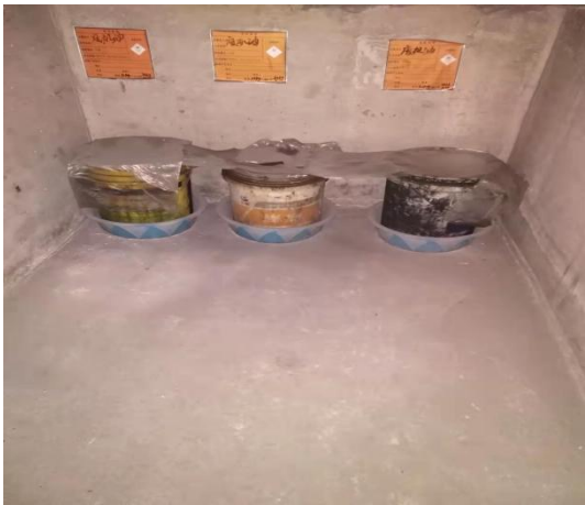
现有废机油暂存库
