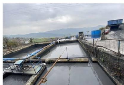
恒泰煤矿矿井水处理站
