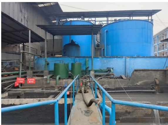
矿井水处理站
