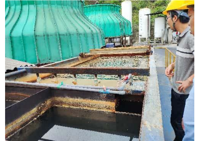
新增一体化气浮机
