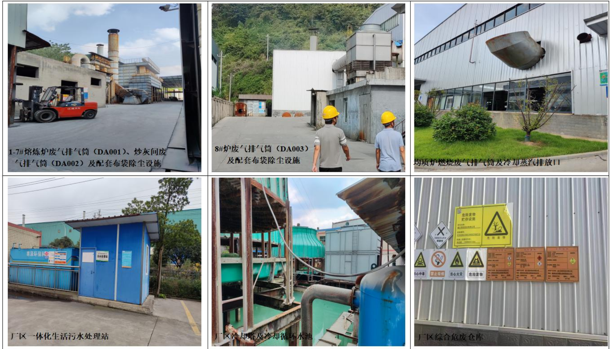
图 3.2.2-1 现有工程厂区主要环保设施掠影图
