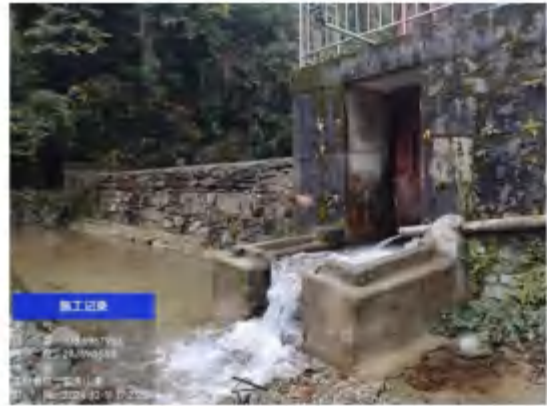
乌坡岭取水坝生态流量泄放设施
