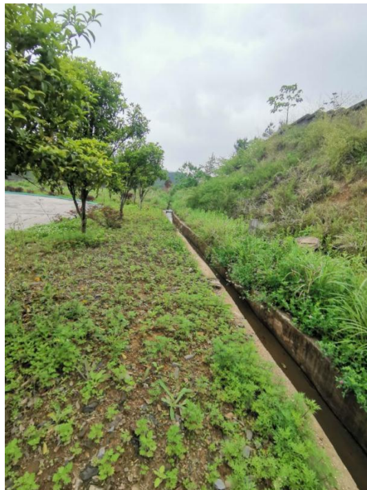
后期雨水排放沟
