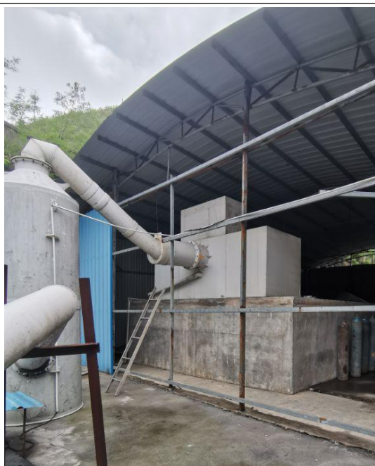
喷淋塔及循环水池
