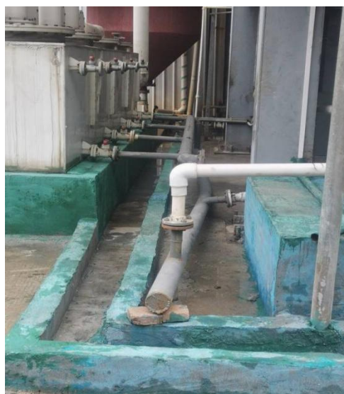
生产线废气处理区域围堰
