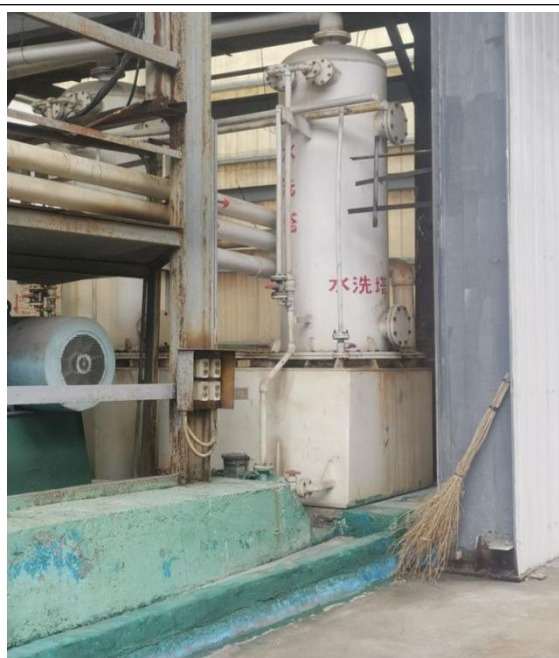
水洗塔及生产区围堰
