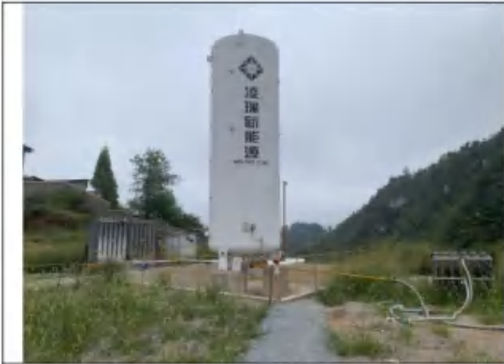
液化天然气罐
