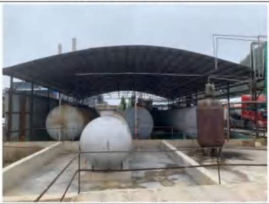
纤维素原料储罐区
