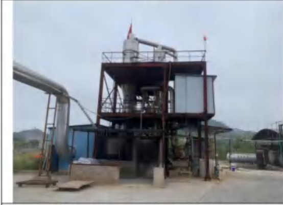
纤维素生产废水处理系统
