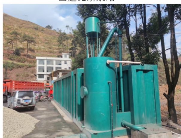
主工业场地已建生活污水处理站
