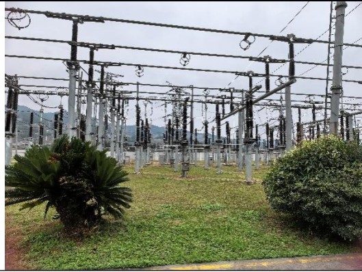
220kV 间隔区域现状
