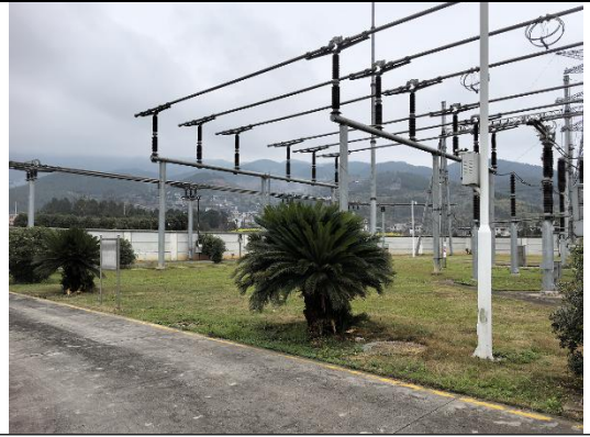
110kV 间隔区域现状
