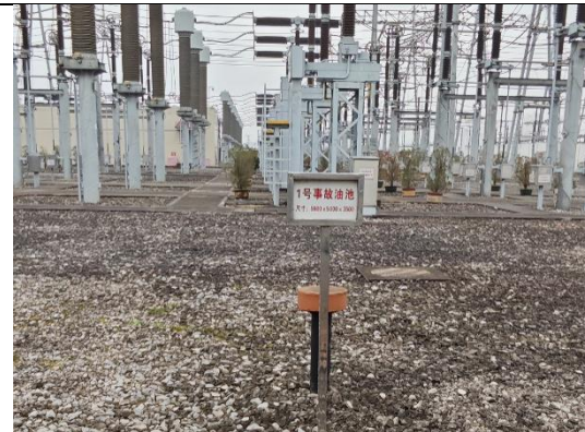
主变事故油池
