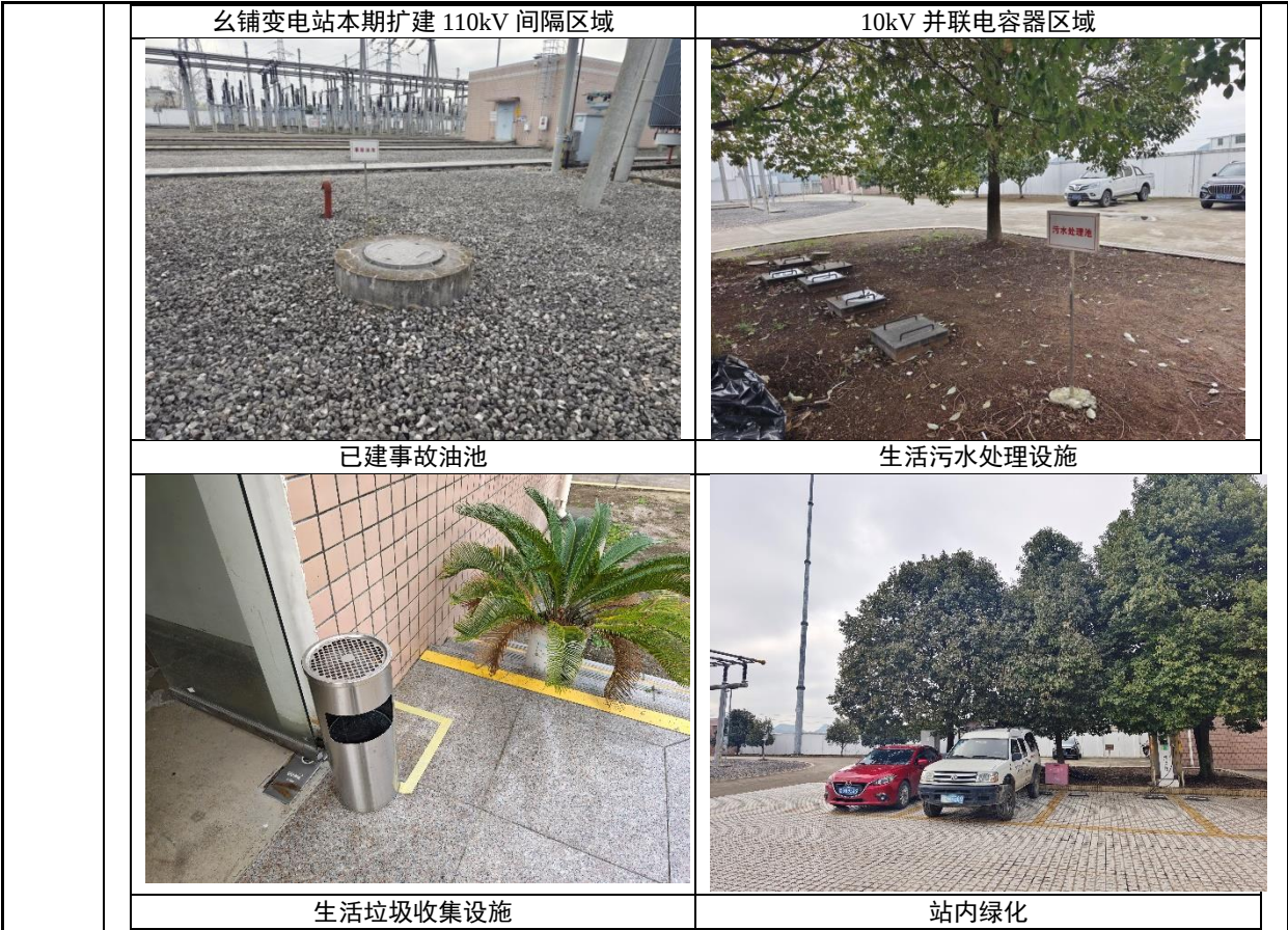
图 1 220kV 么铺变电站实景照片
