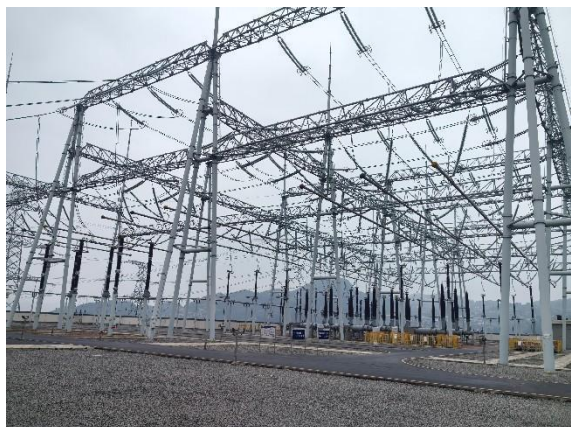
500kV 户外配电装置区
