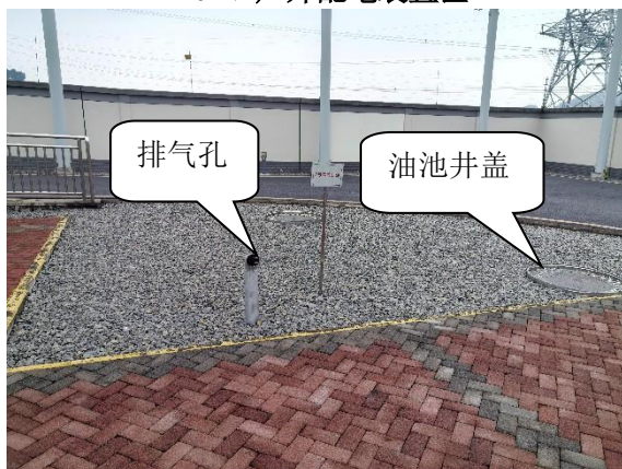
已建事故油池
