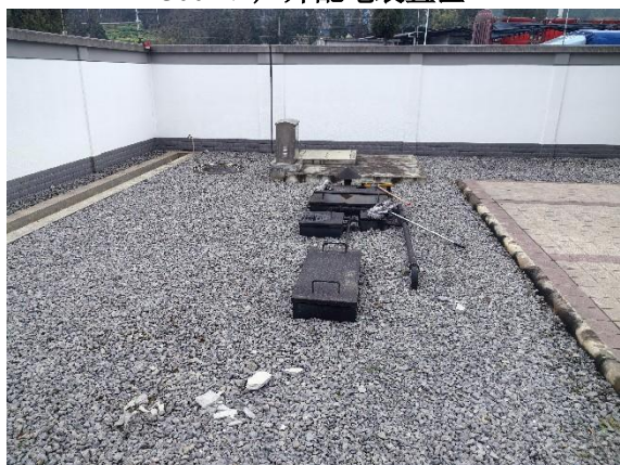
地埋式污水处理装置
