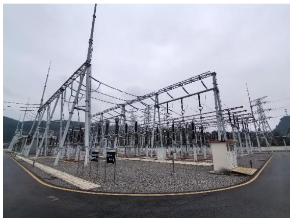
220kV 户外配电装置区
