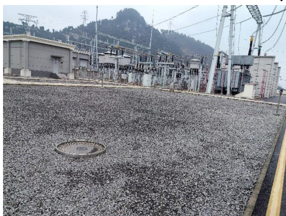
本期#1 主变扩建预留场地
