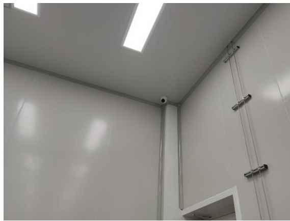
北侧右上角监控摄像头
