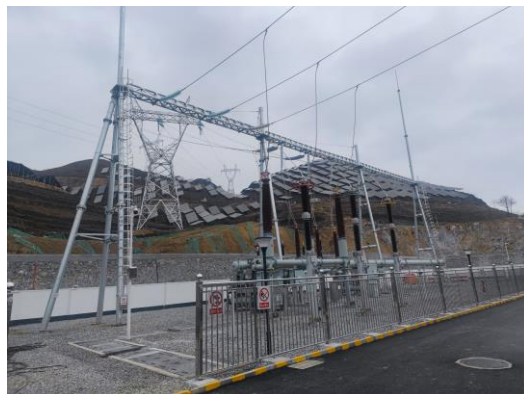
220kV配电装置
