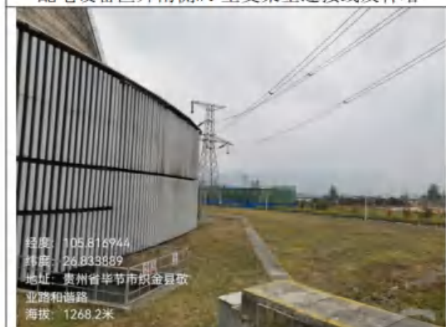
#2 主变架空连接线情况
