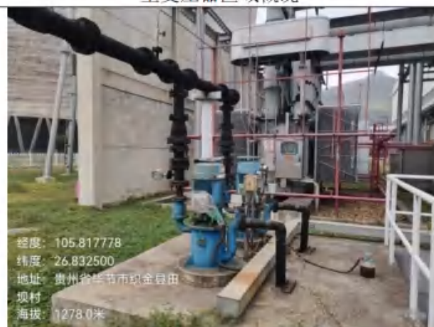
#2 主变压器及防火墙
