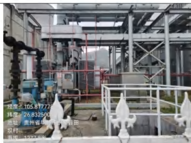
主变压器区域概况
