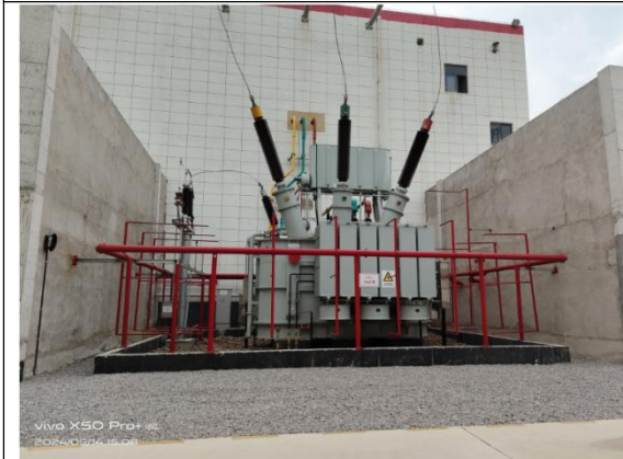
1#主变及储油坑
