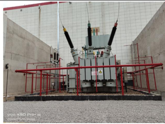
2#主变及储油坑
