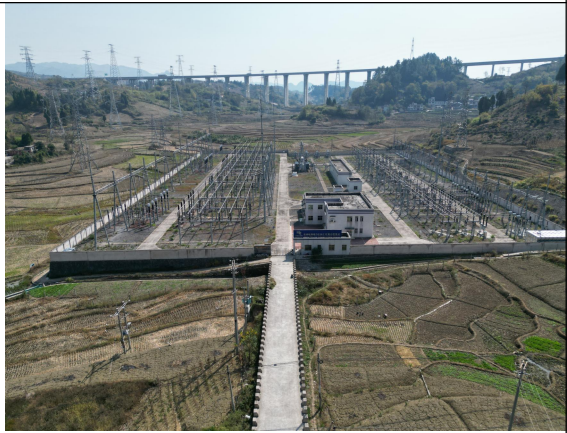
凤山 220kV 变电站
