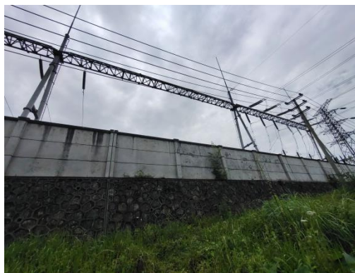
220kV 下坝变电站间隔扩建侧
