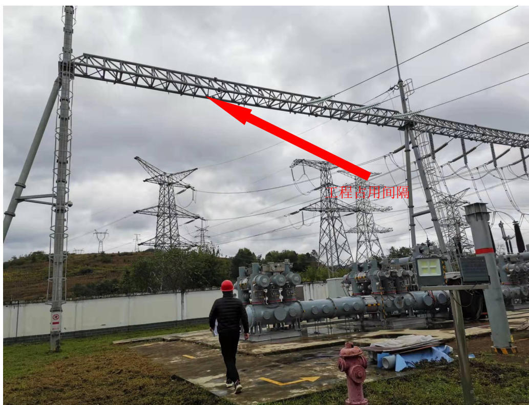
图 2-1 大方变电站 220kV 侧出线情况
