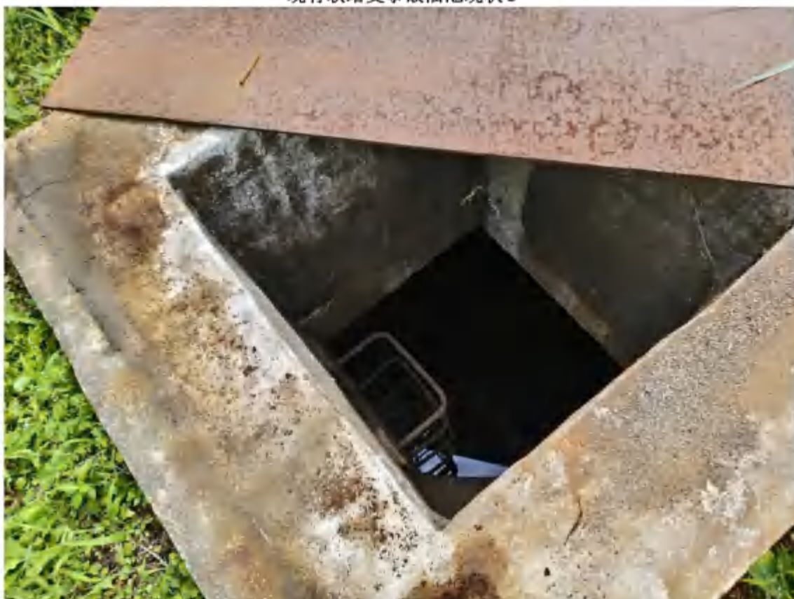
现有联络变事故油池现状 4
