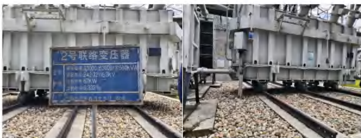
2#联络变压器现状照片
