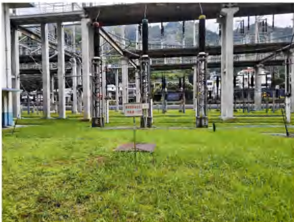
现有联络变事故油池现状 1
