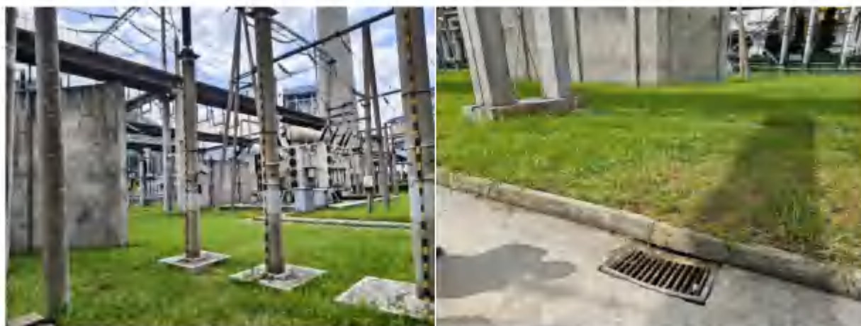
变电站区域内现状
