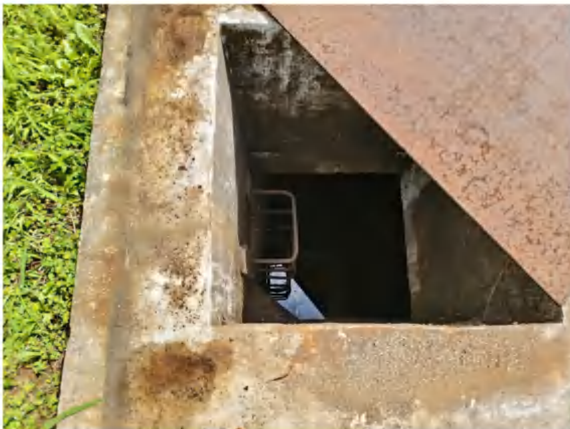
现有联络变事故油池现状 3
