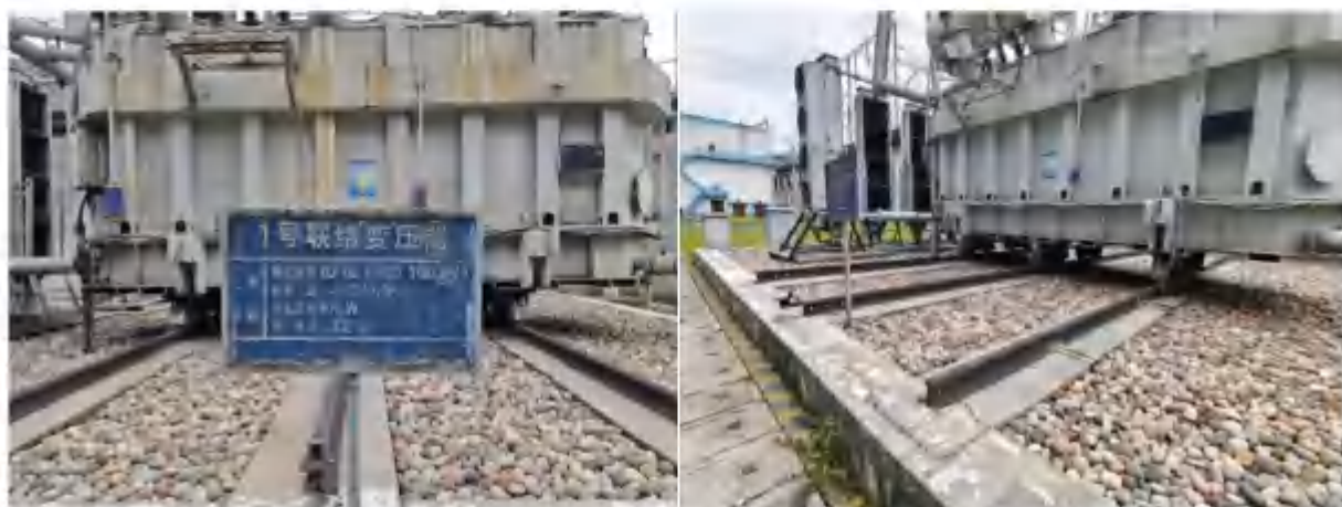
1#联络变压器现状照片
