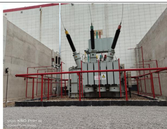
已建 2#主变及储油坑
