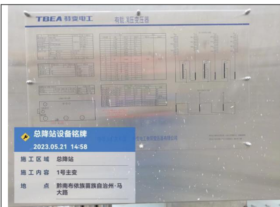
已建的 1#主变铭牌
