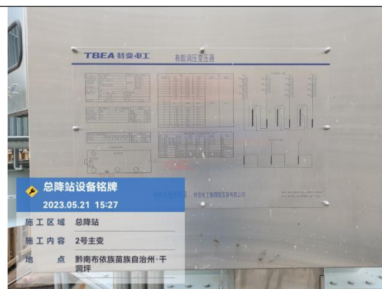
已建的 2#主变铭牌
