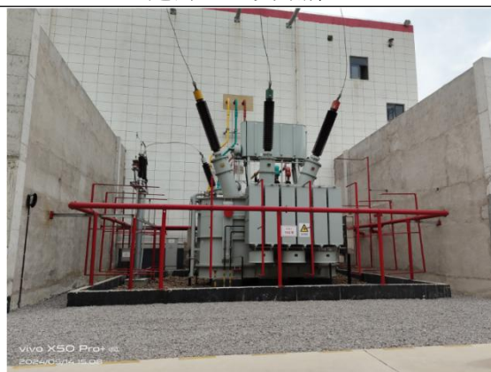
已建 1#主变及储油坑
