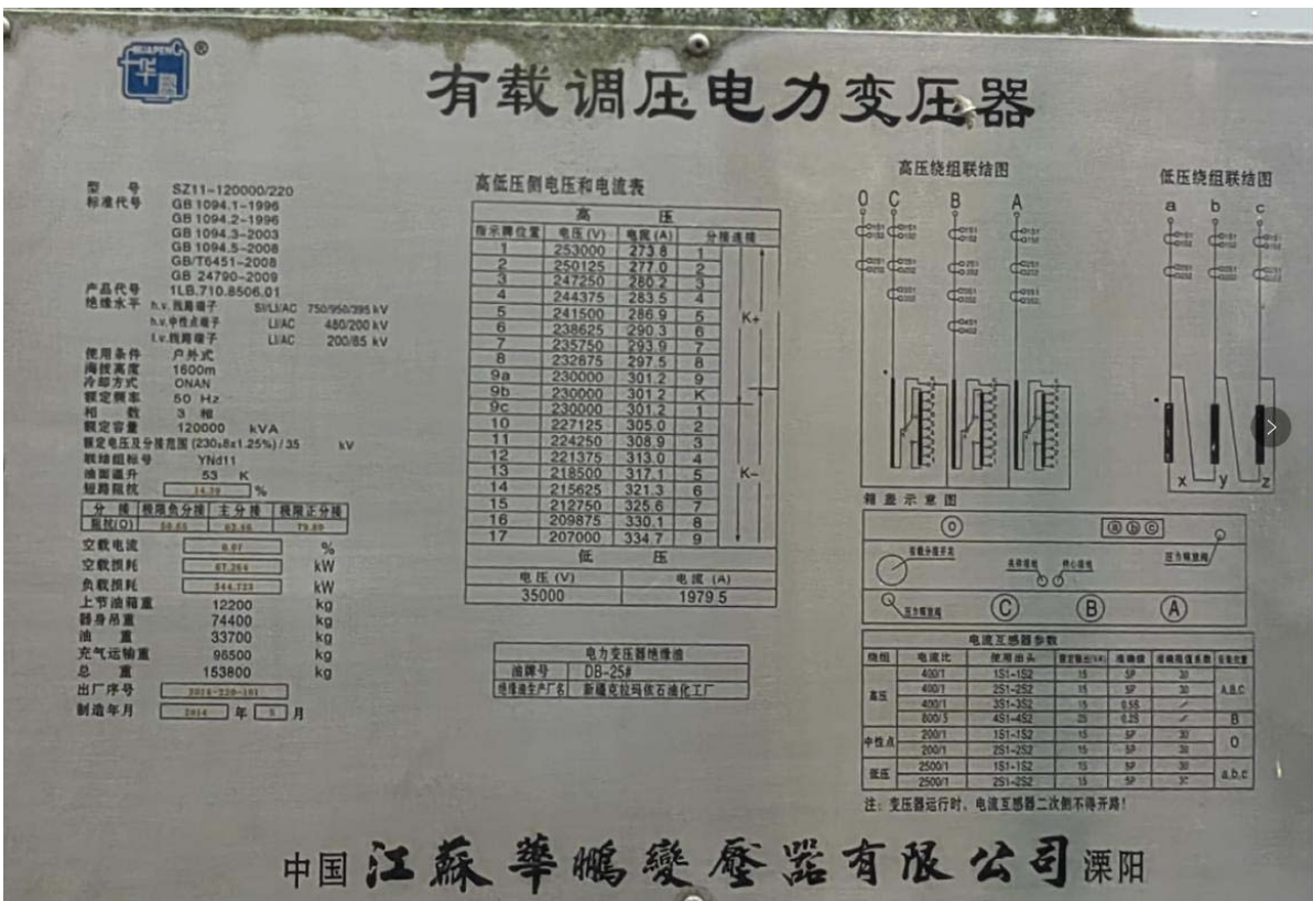
图 3-1 主变压器铭牌照片
