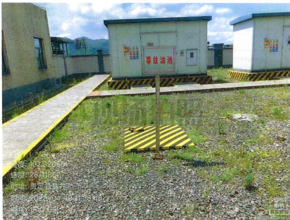
图三地埋式事故油池现场照片
