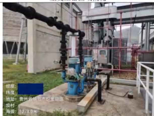
#2 主变压器及防火墙
