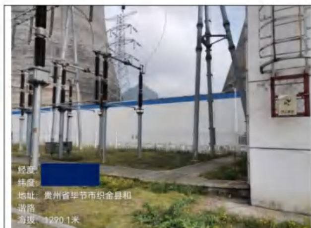
配电设备区外南侧#1 主变架空连接线及杆塔
