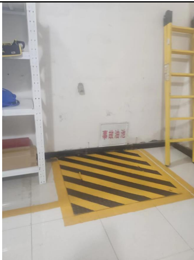
主变洞内设置的 130m 事故油池
