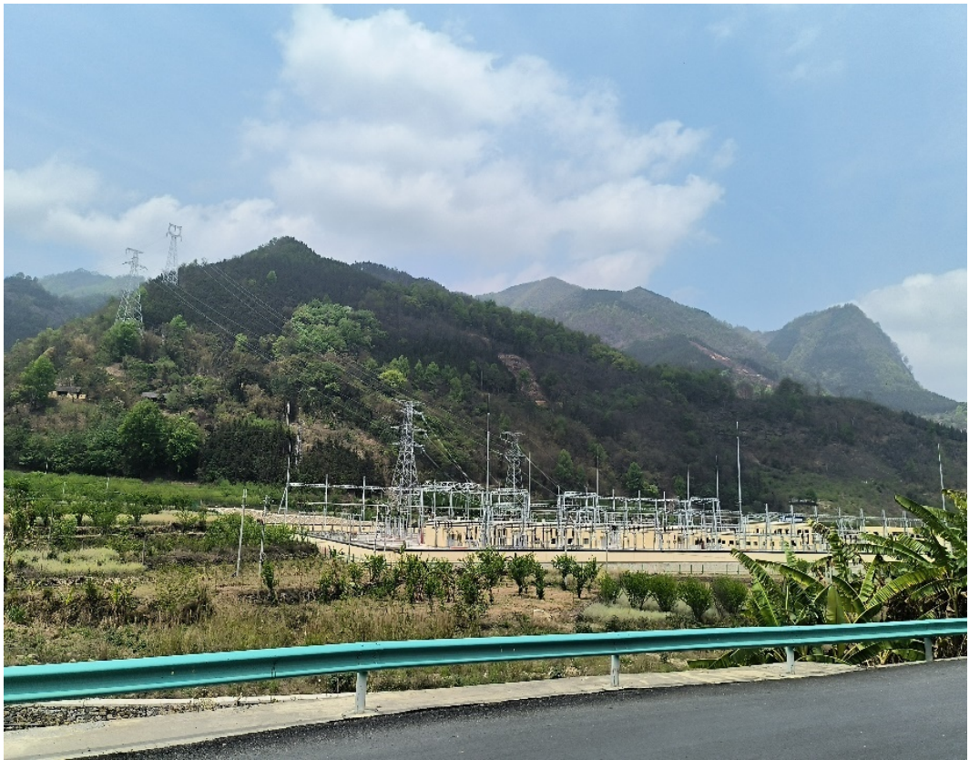
高洛 220kV 变电站现状
