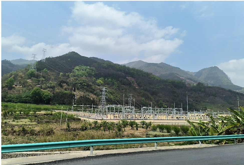
高洛 220kV 变电站现状
