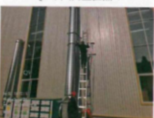
Q9: 挤出线排气筒出口
