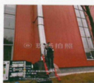
Q18: 挤出线排气筒出口
