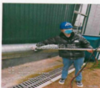
Q12: 电缆生产排气筒进口
