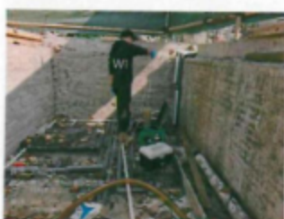
生活污水总排口
