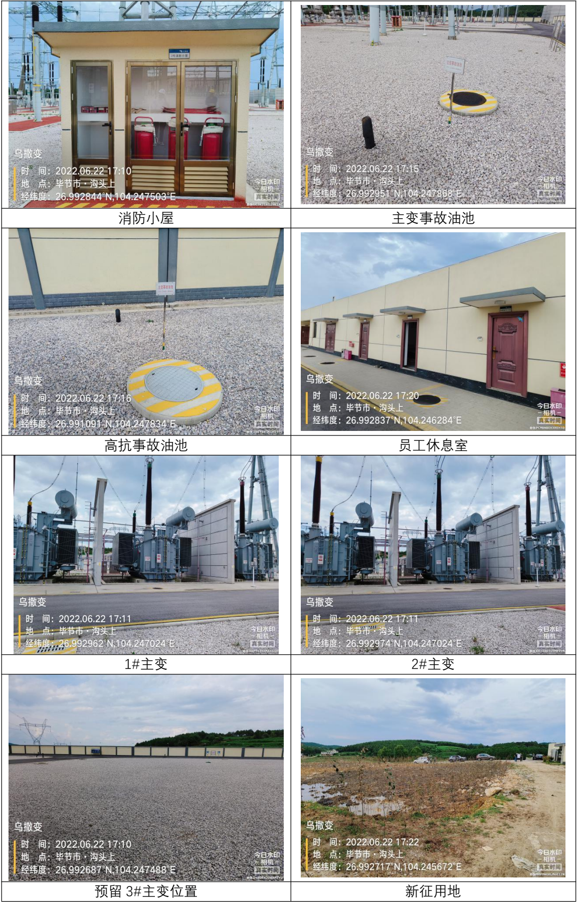
图 3.1-1 500kV 乌撒变电站现场照片
