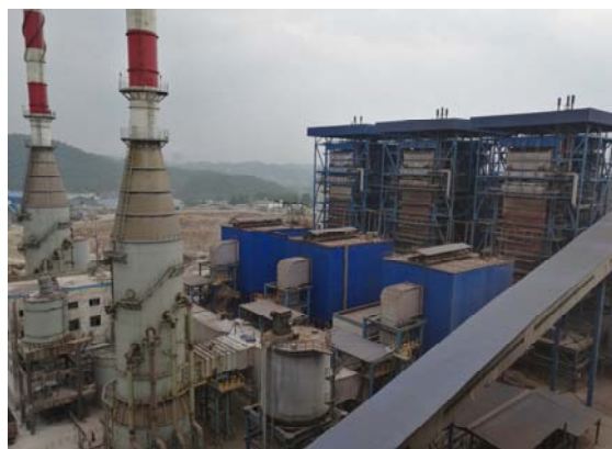
热电锅炉及其烟气脱硫除尘
